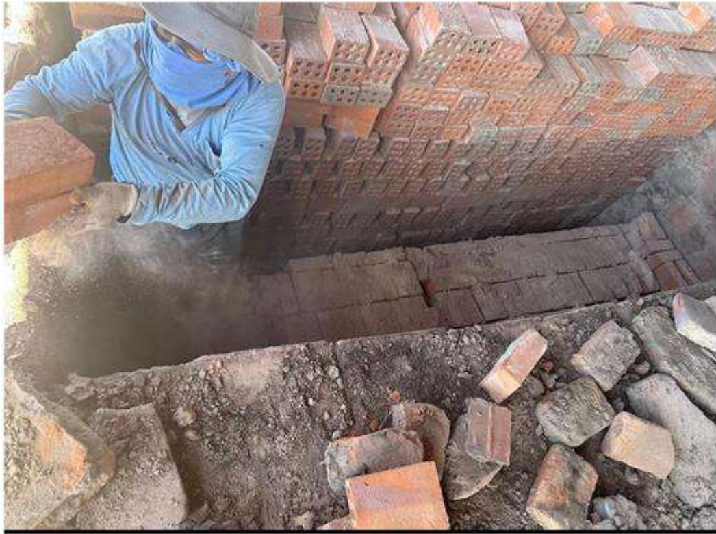
DESCRIPCIÓN: Enfriamiento de los ladrillos y traslado de los mismo al laboratorio de la UCSP y COAQUIRA EIRL.
