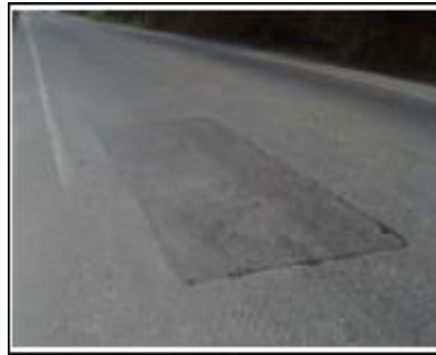
Ilustración 3: Pavimento con deterioro superficial
